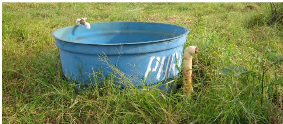
Figura 2 - Caixa d'água de fibra de vidro
